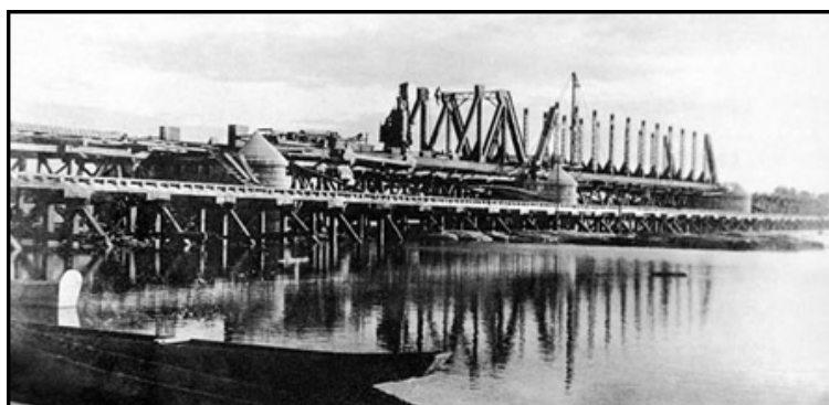
Figura 02: Construção da Ponte Marechal Hermes. Fonte: Revista do Instituto Histórico e Geográfico de Montes Claros, 2013.
